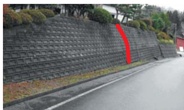
擁壁下端のハラミ出し
