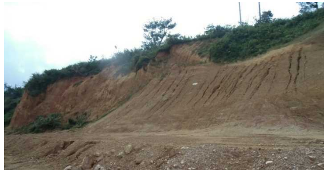
・盛土法面にガリ侵食が確認される
