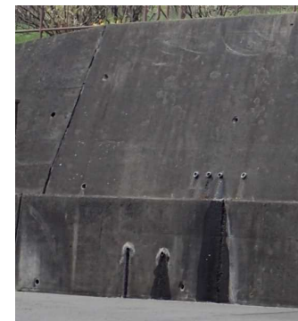
・擁壁の水抜き孔からの湧水により常時湿っている ・湧水の痕跡（白色部）も確認される
