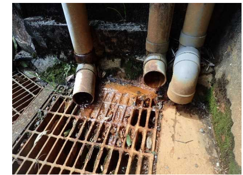
・水抜き孔からの湧水により常時湿っている（鉄分を含むことを示唆する赤褐色物質が沈積）
