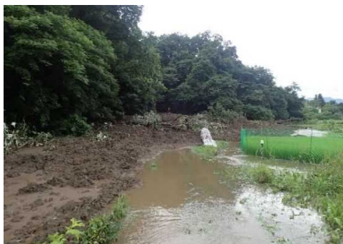
応急対策工事前
