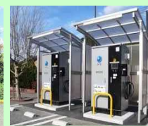
EVバス充電施設の設置
