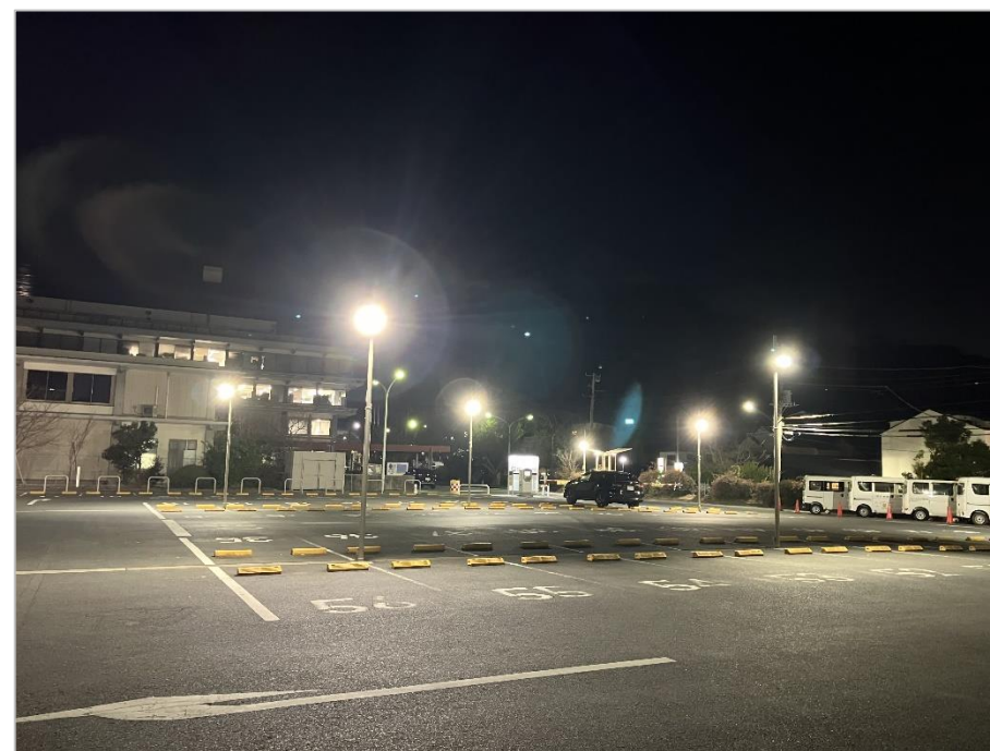
夜間照明施設の設置状況
