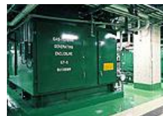
非常用発電機
