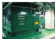
非常用発電機
