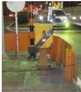
老朽化した踏切保安設備
