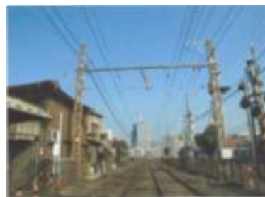
整備された電車線
