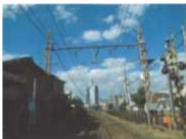
老朽化した電車線
