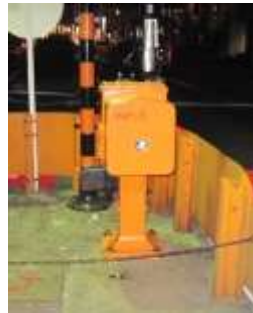
更新された踏切保安設備
