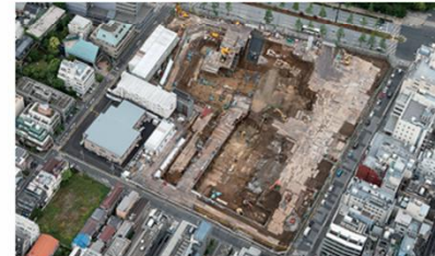
四谷駅前地区(市街地再開発事業) 横構施行により建築中の再開発建物
