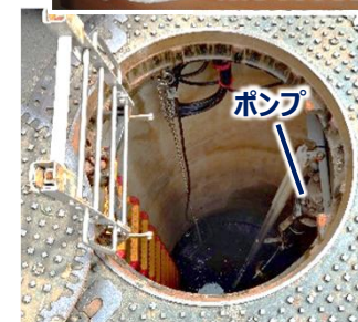
液状化対策施設の例 (千葉県千葉市)
