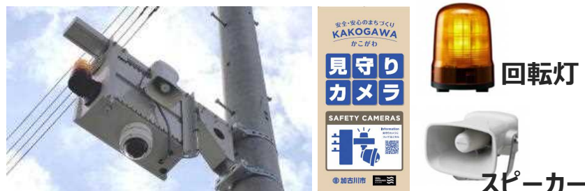
図.新設されたAI高度化カメラの機能イメージ
