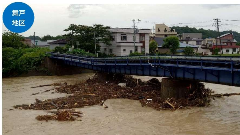
曲がった鉄道橋（8月10日7時頃撮影）
