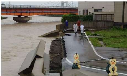
崩落した護岸（8月10日8時頃撮影）
