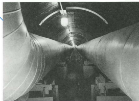
図：熱導管（創成川橋所管） ※ 札幌市熱供給公社提供
