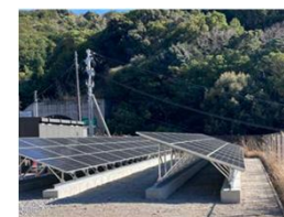
太陽光発電施設
