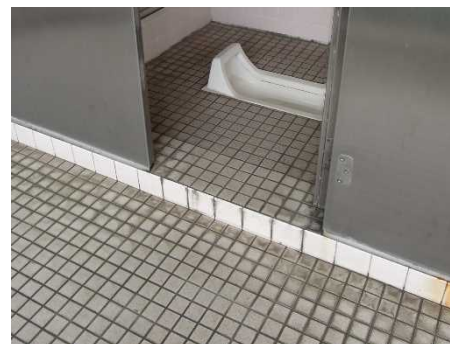
床面に段差があり、腰掛便座ではない
