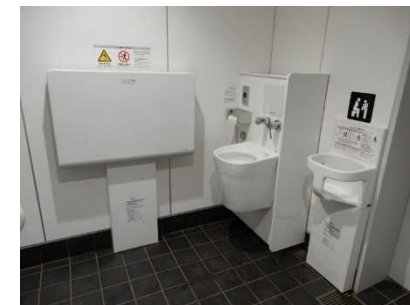
車椅子使用者、オストメイト、乳幼児連れ利用者に対応した設備を備えたトイレの例
