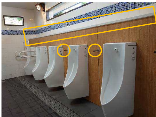
杖・傘等のフック、手荷物棚の例 床面や壁面と便器のコントラストが明確になっている。
