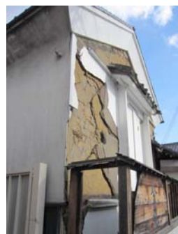
■白河市における土蔵の被害
