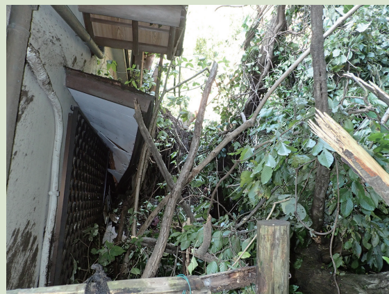
倒木等により被害にあった住宅(提供:神奈川県)
