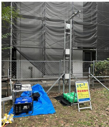
設置したLiDARスピーカー
