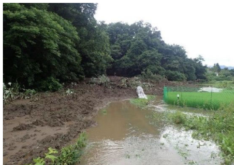
応急対策工事前
