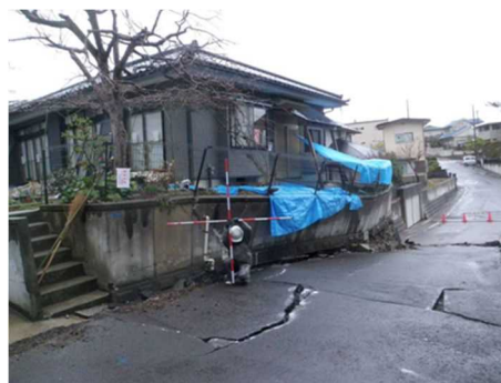
b) 宅地擁壁の崩壊
