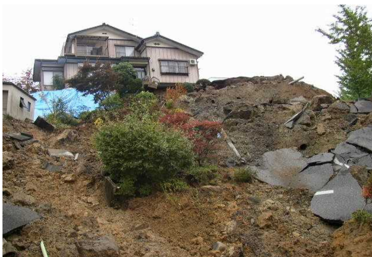
図参 1.1.8 新潟県長岡市高町の盛土造成地の滑動崩落現象その2
