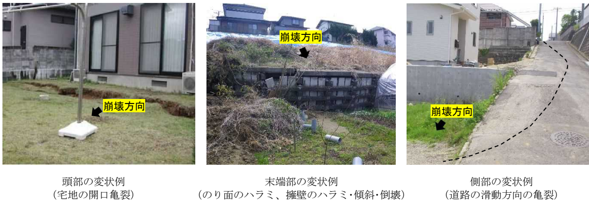
図 3. 2. 1 崩壊を示唆する変状の例
