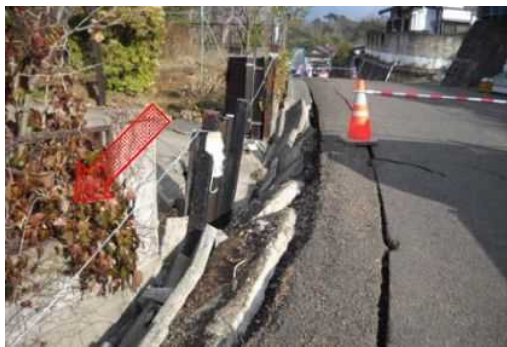
a) 盛土頭部のクラック
