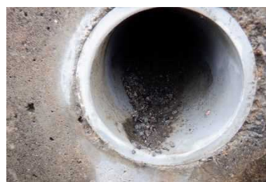
水抜き穴の内部に土砂が堆積
