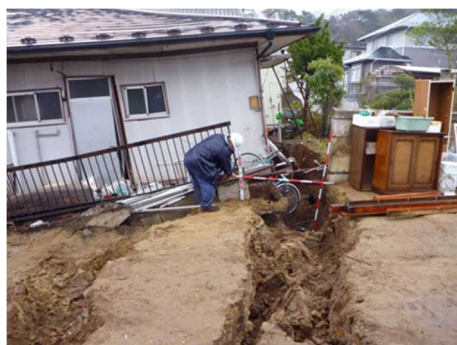
a) 宅地地盤のクラック
