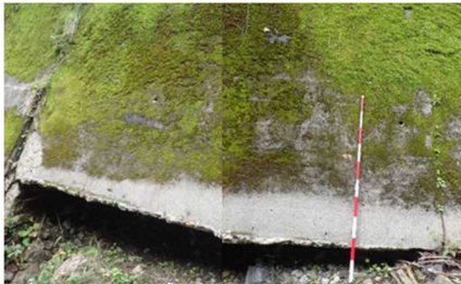
(a) 擁壁の基礎部における不安定な土層（崖錐堆積物）
