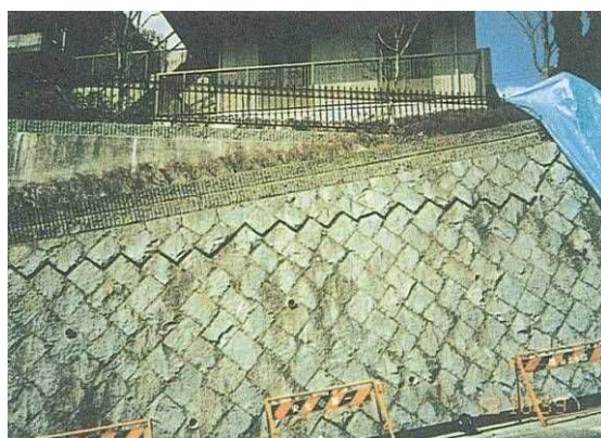
図 9.5 擁壁の沈下例 2
