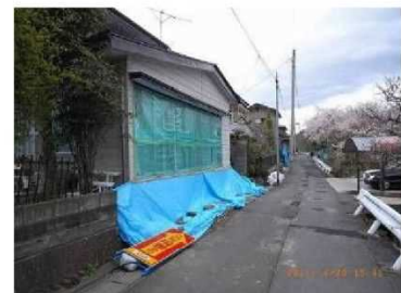
図参2.3 杭間の変形による 家屋の損壊
