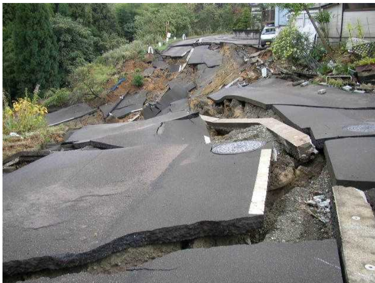
図参 1.1.7 新潟県長岡市高町の盛土造成地の滑動崩落現象その1
