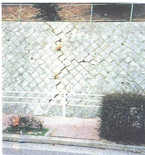
図 9.4 擁壁の沈下例 1
