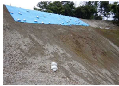
(b) 盛土のり面勾配が急で肌落ちがあり、擁壁工や構造物によるのり面保護工がない
