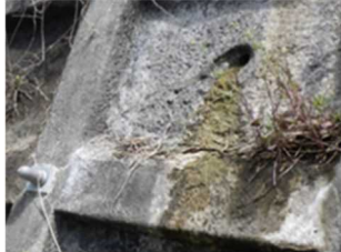
(c) 水抜き穴からの湧水
