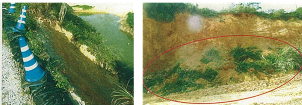
図参 1.1.3 切土の表層崩壊の様子
