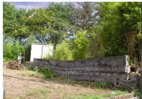
b) 宅地擁壁及び基礎地盤の被害
