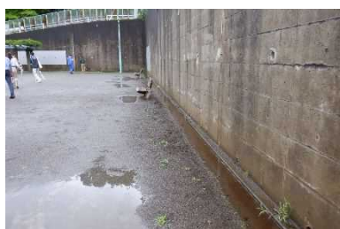
擁壁前面に土砂が堆積
