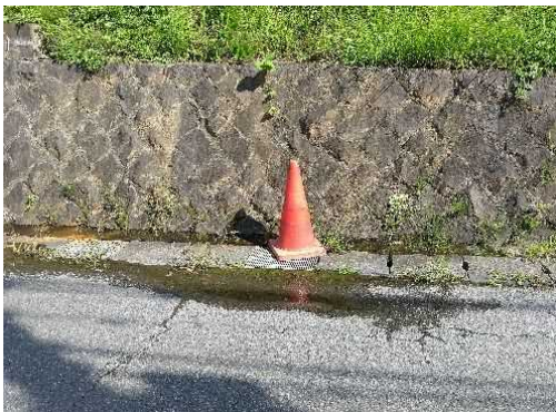
擁壁下部からの水のしみ出し
