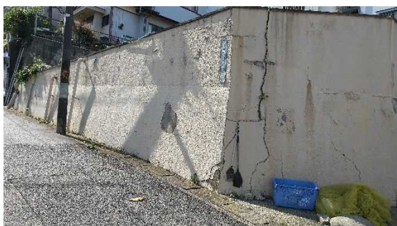
③擁壁単体の劣化
