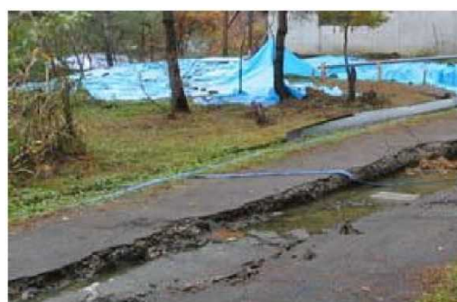
道路の沈下・段差
