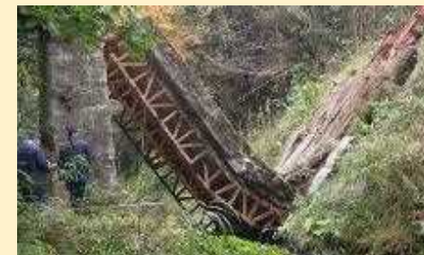
香川・徳島県境無名橋の落橋 (2007年)
