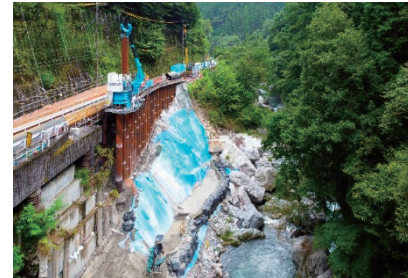
大雨で道路擁壁が崩落（日本） →難条件（狭隘・高所）での施工が可能
