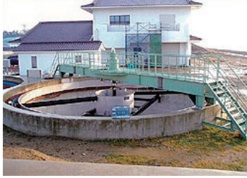
▲掻き寄せ機（汚泥/沈砂）
