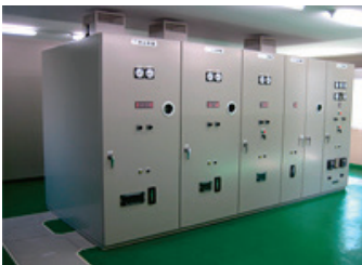
▲受変電盤・制御盤・配電盤
