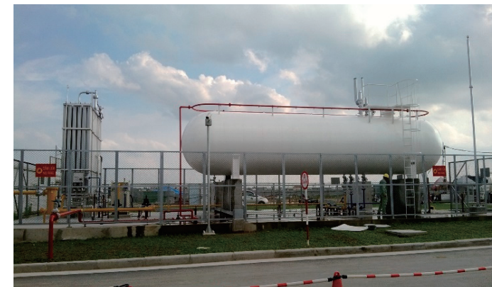
LP ガス供給設備(ベトナム・ハノイ) 25t タンク 空温式気化器・電熱温水式気化器ほか
