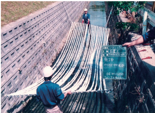
水深の浅い河川へ直接設置
