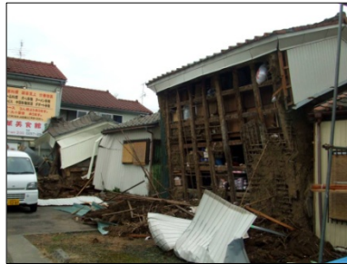
【敷地内部の土蔵の被害】
