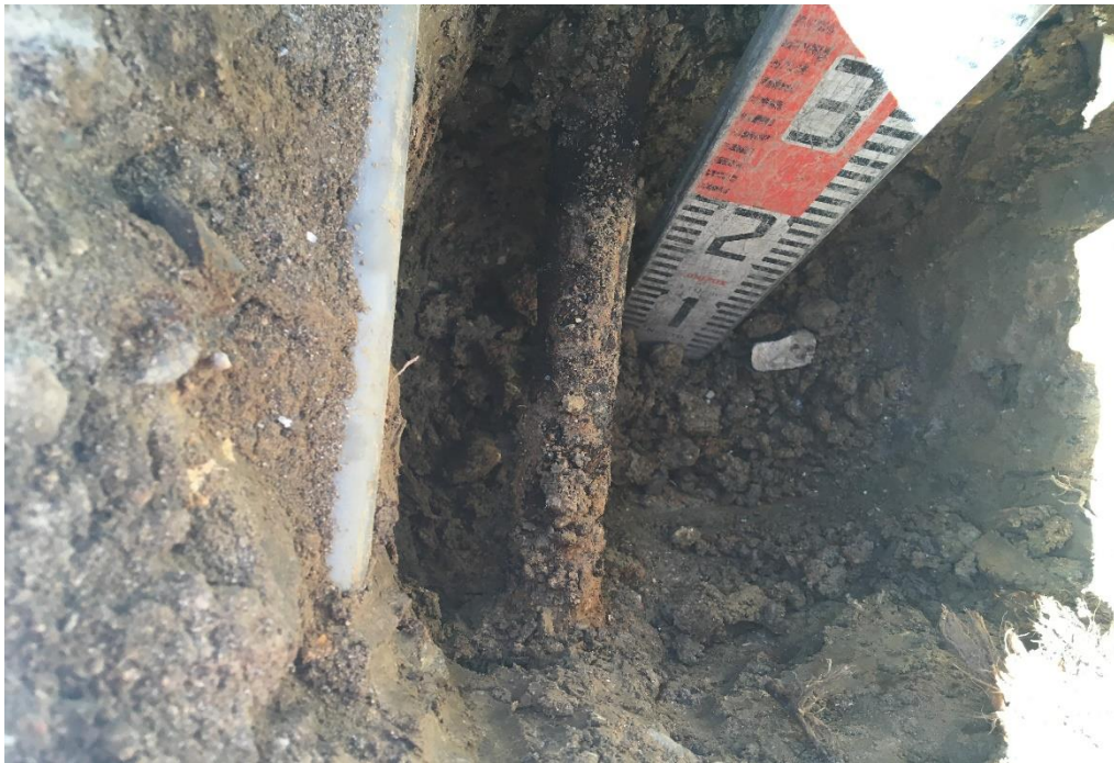
図表8 朽廃した活きたガス管
