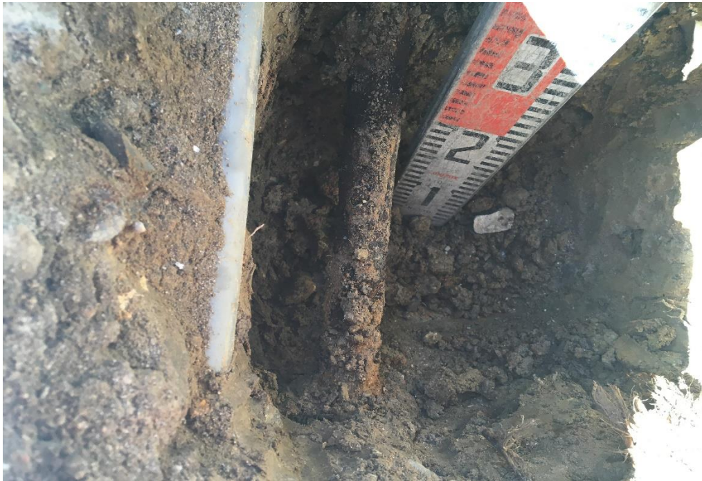
図表 10 朽廃した活きたガス管
