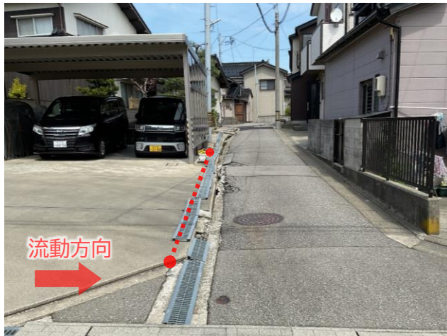
宅地境界が道路側に移動し道路側溝がつぶれている
