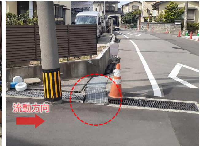
側方移動により道路側溝が変状し損傷している
