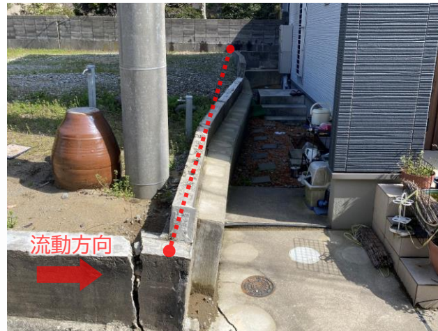
民地間の境界が湾曲し擁壁が損傷している
