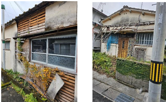
当該空き家の朽廃状況画像
