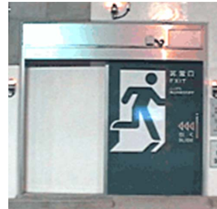
トンネル避難扉 (エスケート)
