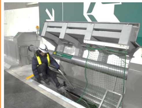
トンネル避難扉 (跳ね上げ式)
