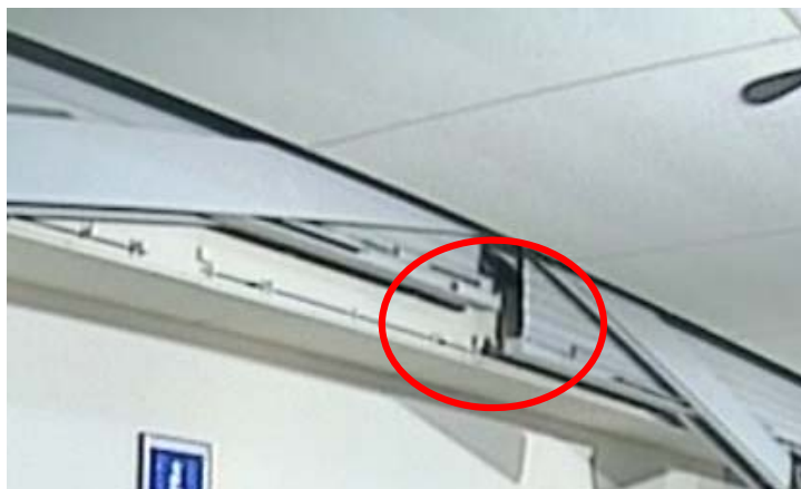
② パネルが開き閉鎖開始 片側のシャッターは少し 遅れて閉鎖を開始する
