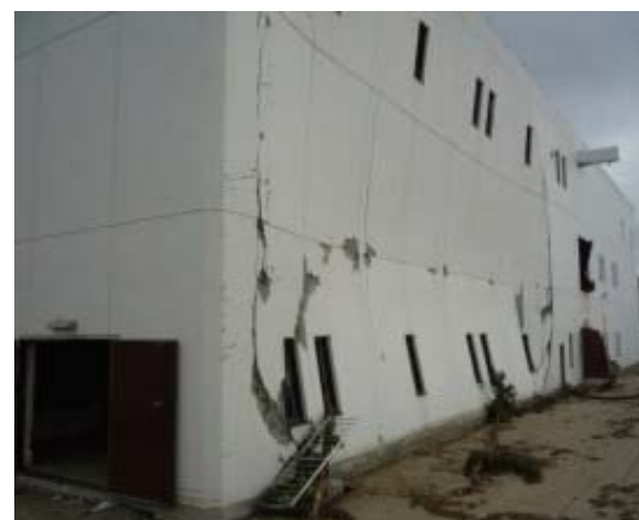
ポンプ場の被災状況
