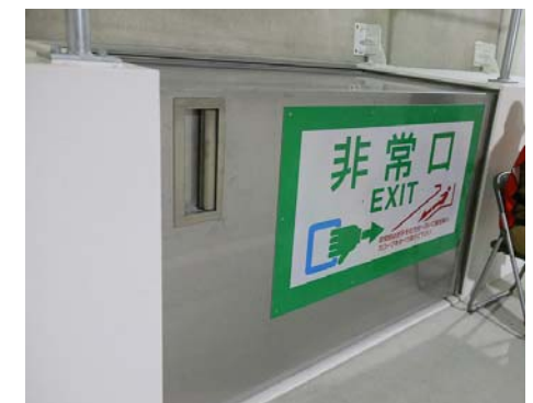
トンネル避難扉 (逆スライド式)
