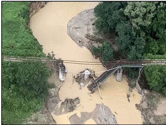
J R東日本米坂線（新潟～山形） の橋梁倒壊 （令和4年8月の大雨）
