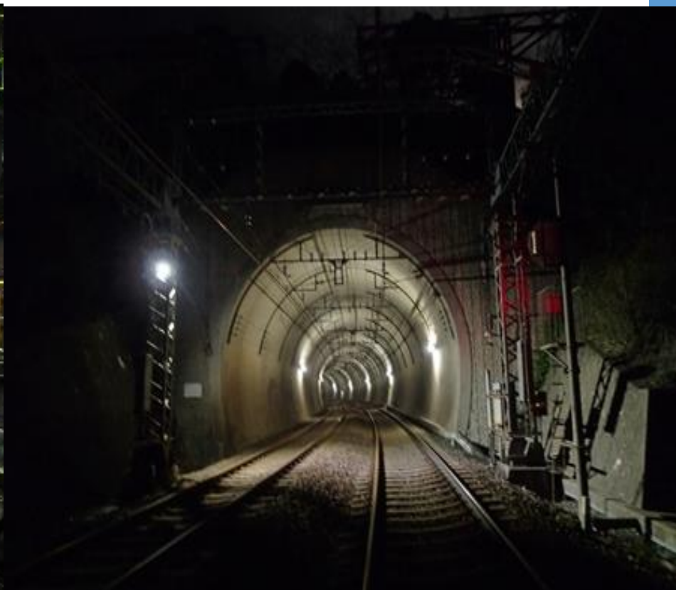
トンネルの坑口照明
