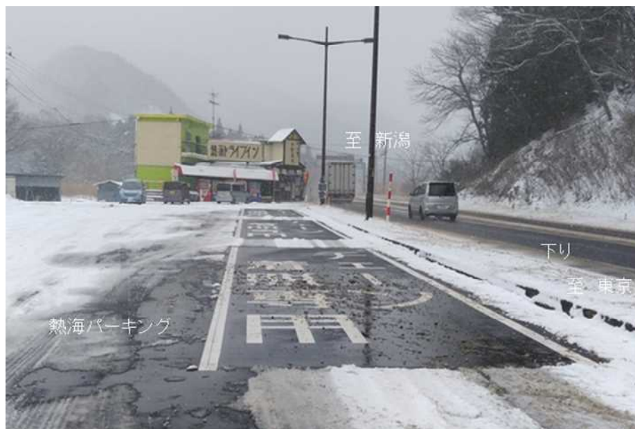
チェーン着脱場の融雪設備整備
