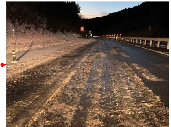
R5.1.24 路面凍結状況 （九州道 横川IC～溝辺鹿児島空港IC間）
