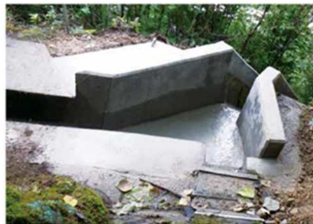
【不具合のあった排水柵の改修後】
