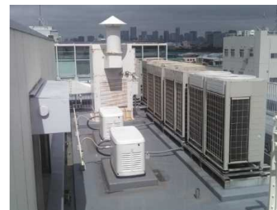
（ANH 本社屋上電源設備）
