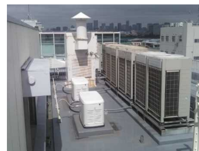
（ANH 本社屋上電源設備）
