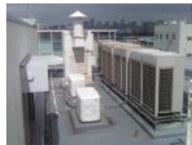
（ANH 本社屋上電源設備）
