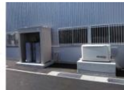
（ANH 福岡基地電源設備）
