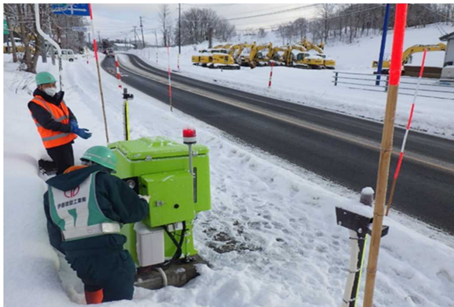
凍結抑制剤自動散布装置の設置
