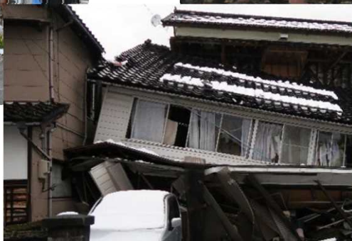
木造建築物の倒壊状況（穴水町）
