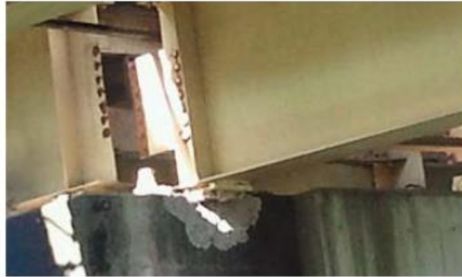
平成28年4月15日10時 被災後の状況
