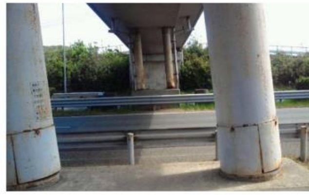
平成28年4月16日 13時 被災後の状況
