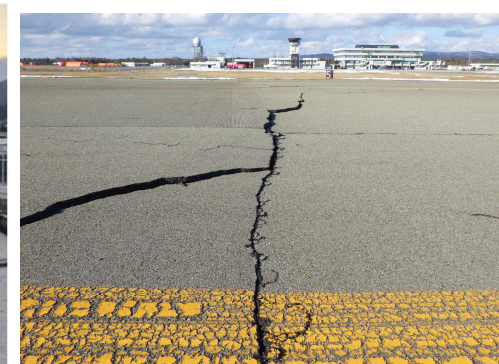
能登空港の被災（穴水町）
