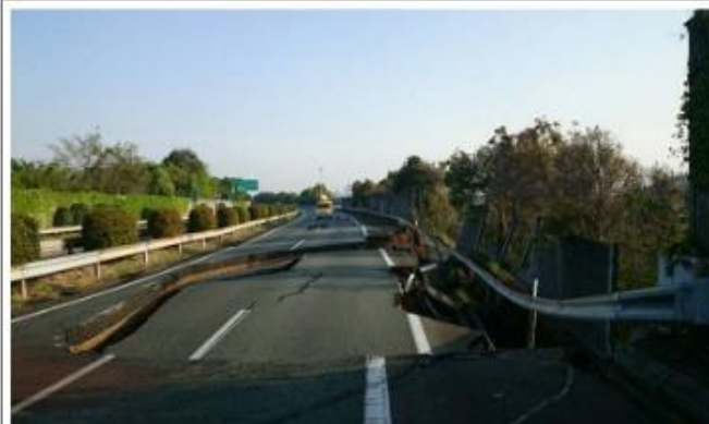
平成28年4月15日8時 被災後の状況
