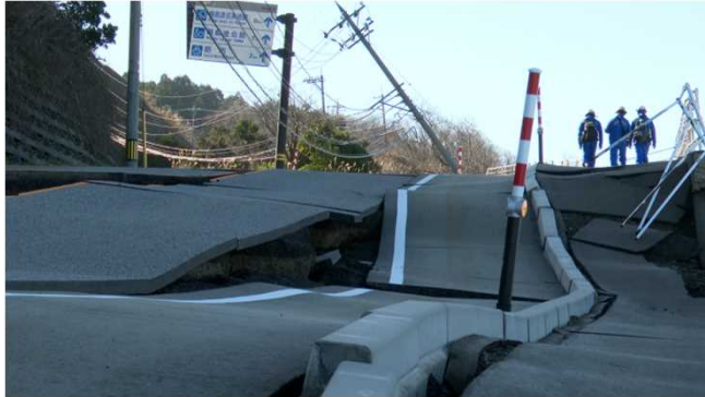
国道249号道の駅千枚田付近（輪島市）
