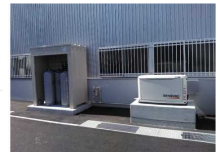
（ANH 福岡基地電源設備）
