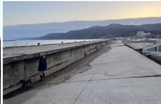
輪島港の被災（輪島市）
