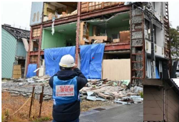
建築物の損壊状況（七尾市）
