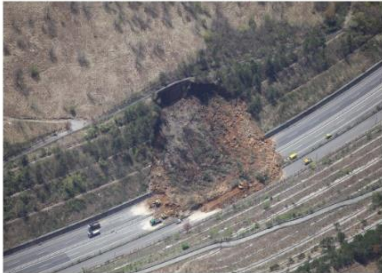
平成28年4月16日12時 被災後の状況
