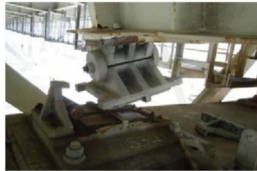
平成28年4月21日 被災後の状況
