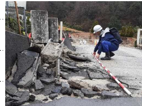
岩屋浄水場の被災（七尾市）
