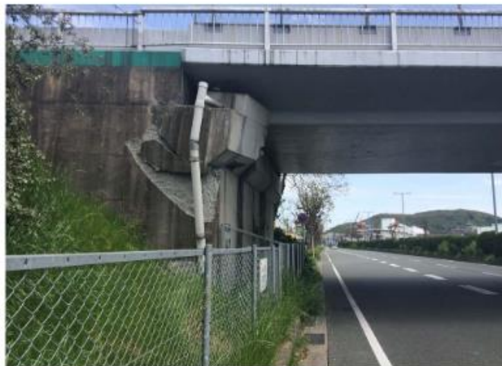
平成28年4月16日11時 被災後の状況
