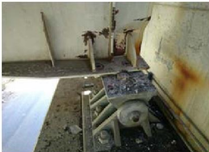
平成28年4月21日 被災後の状況
