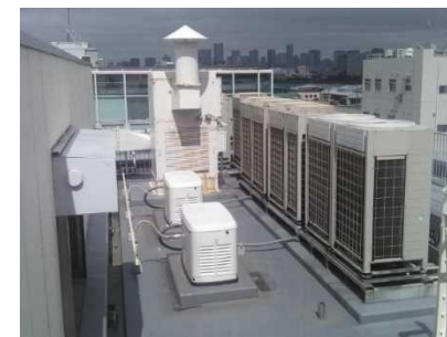
（ANH 本社屋上電源設備）
