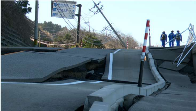
国道249号道の駅千枚田付近（輪島市）
