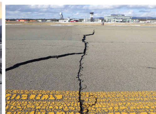
能登空港の被災（穴水町）
