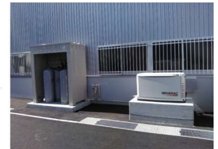
（ANH 福岡基地電源設備）
