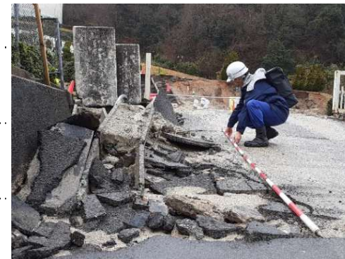
岩屋浄水場の被災（七尾市）
