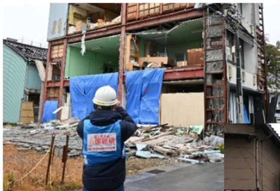
建築物の損壊状況（七尾市）
