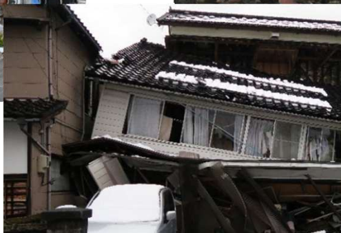
木造建築物の倒壊状況（穴水町）
