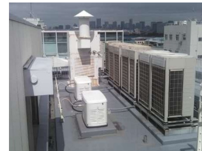
（ANH 本社屋上電源設備）
