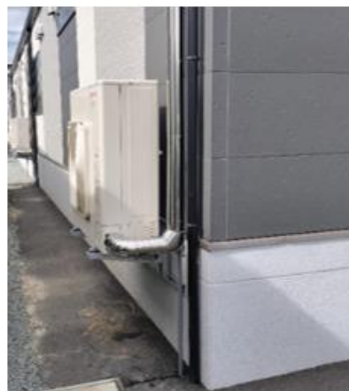
室外機もかさ上げしている
