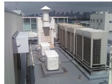
（ANH 本社屋上電源設備）
