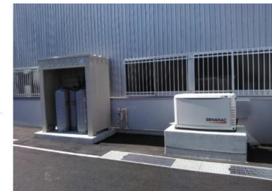
（ANH 福岡基地電源設備）
