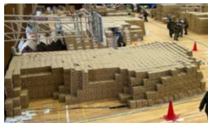
床が抜け落ちた体育館
