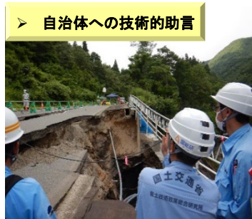
【令和4年8月の大雨】 (山形県米沢市)
