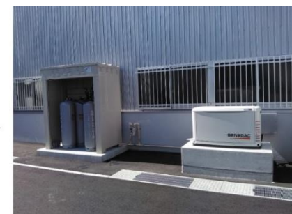
（ANH 福岡基地電源設備）
