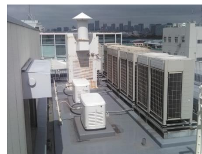
（ANH 本社屋上電源設備）
