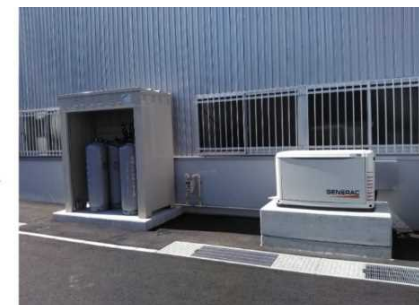
（ANH 福岡基地電源設備）
