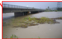
H29.9.18【風水害】長流川（伊達市） 降雨量：24h 71.0mm【観測史上3位】 【計画高水位超過（長流橋上流）】
