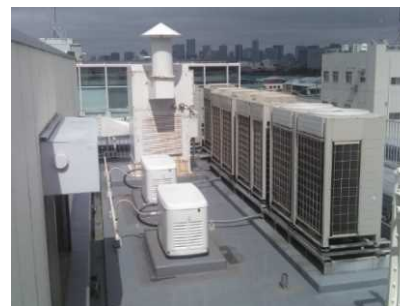
(ANH 本社屋上電源設備)
