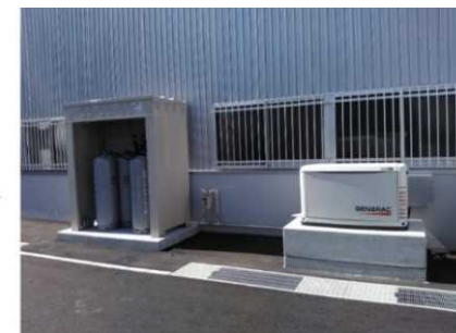
(ANH 福岡基地電源設備)
