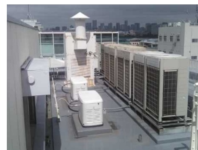
（ANH 本社屋上電源設備）
