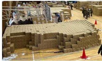
床が抜け落ちた体育館
