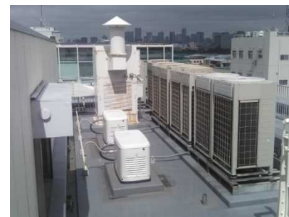
(ANH 本社屋上電源設備)
