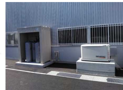
(ANH 福岡基地電源設備)
