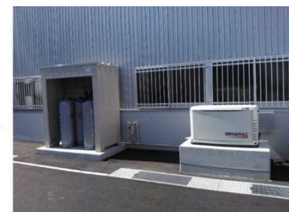
(ANH 福岡基地電源設備)
