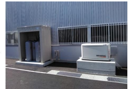
(ANH 福岡基地電源設備)
