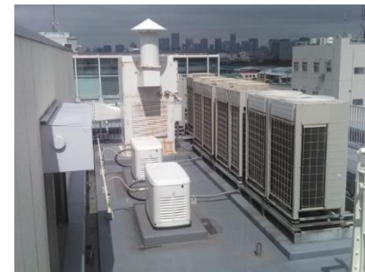
(ANH 本社屋上電源設備)
