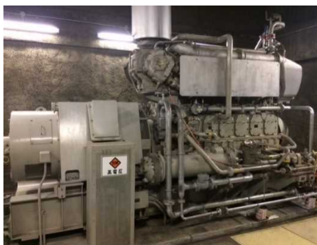
<自家発電機／新潟港>
