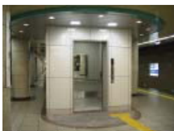
障害者対応型エレベーター
